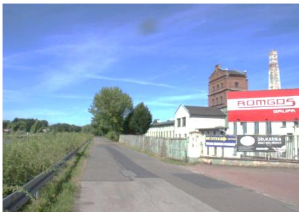
Fotografia 127 Stan nawierzchni jezdni ul. Nadbrzeżnej
