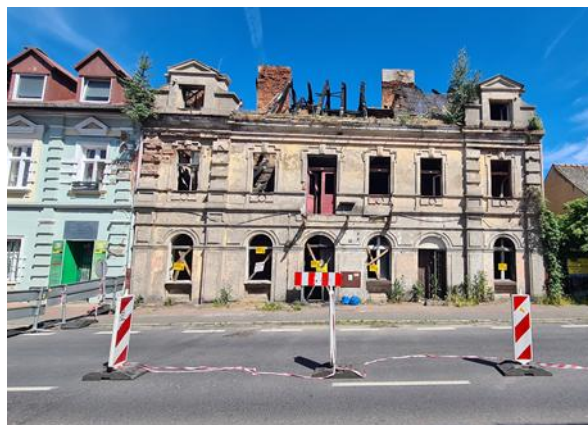
Fotografia 118 Zdegradowany budynek po pożarze przy ul. 3 Maja 45
