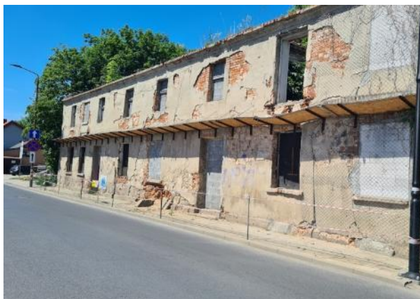
Fotografia 117 Zdegradowany budynek przy ul. Zofii Urbanowskiej 10
